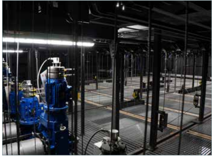
Das Friedrichsforum fungiert als Gastspielhaus und benötigt eine flexible und leistungsfähige technische Ausstattung
